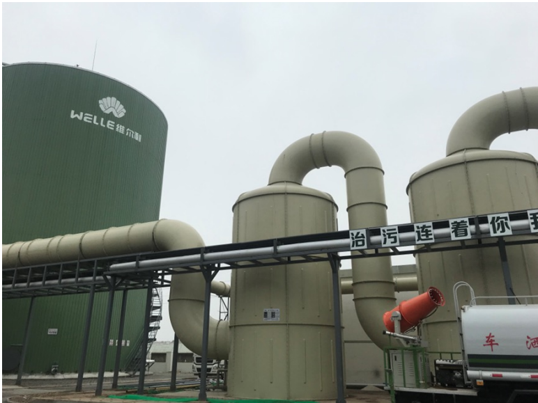
图 14. 陕西省西安市餐厨垃圾资源化利用和无害化处理一期项目设施
