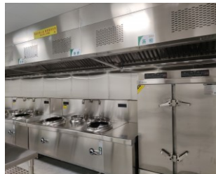
全电化厨房（公共建筑）
