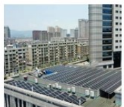
屋顶光伏（BAPV）
