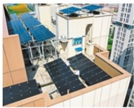
住宅楼屋顶光伏（BAPV）
